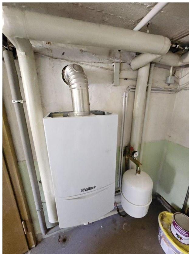
Gas-Etagenheizung für das EG
