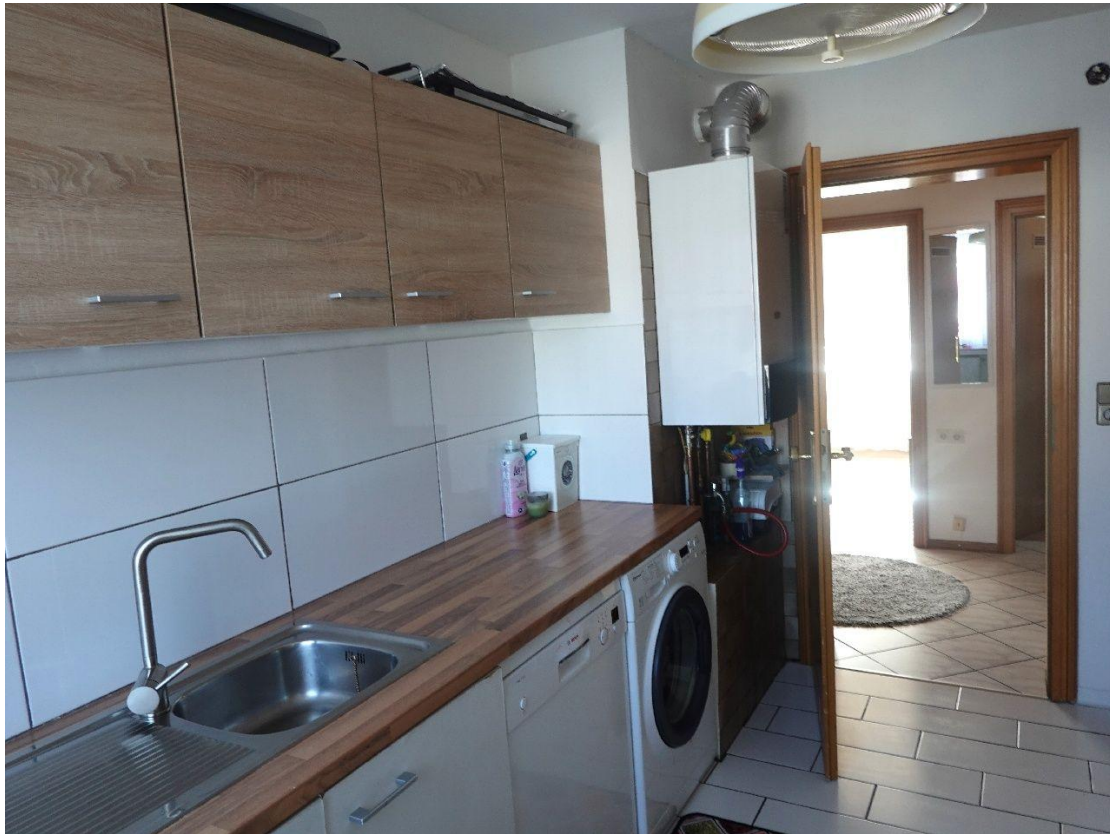
Neue Gasetagenheizung (Bj.2024)
