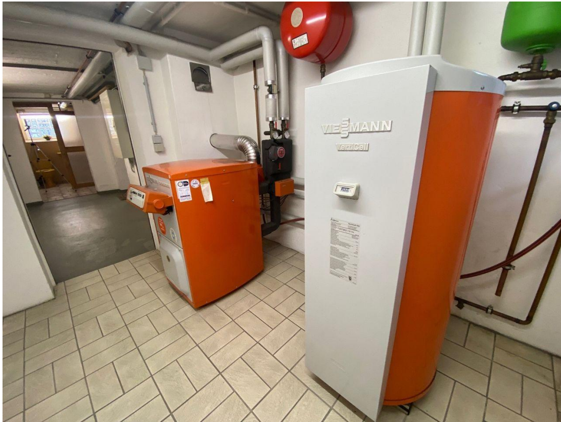
Heizung vom EG
