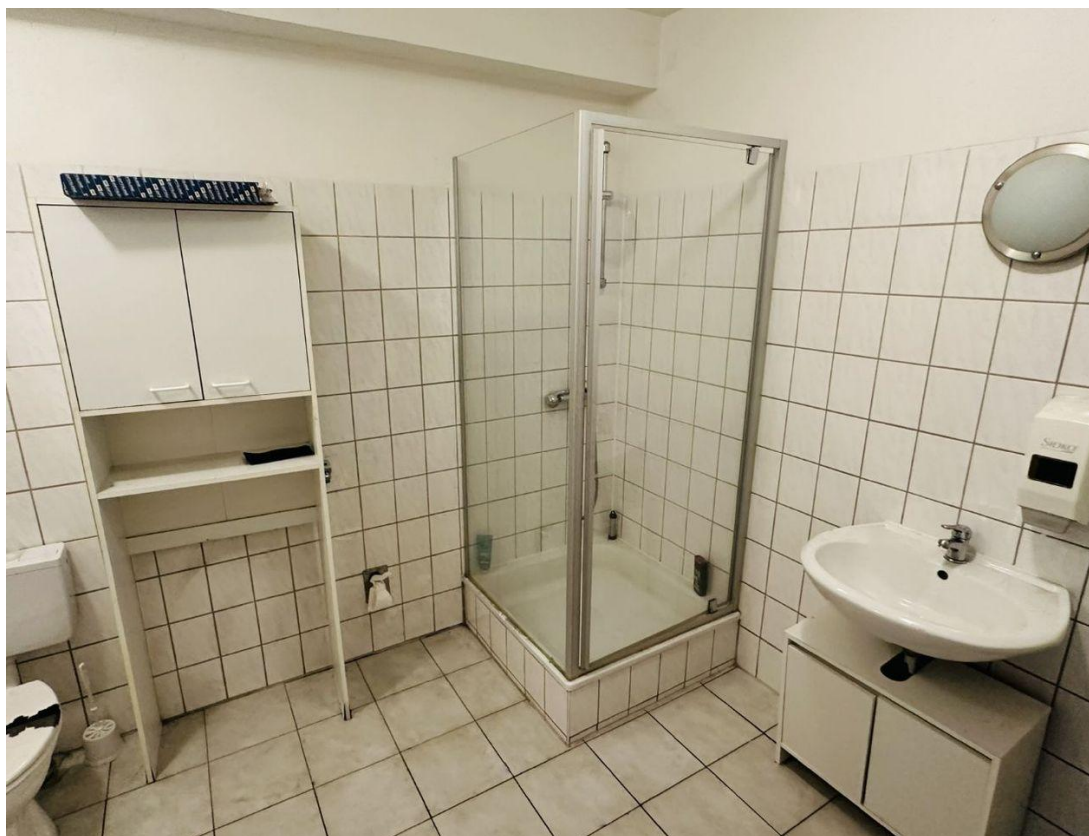
Waschraum mit WC
